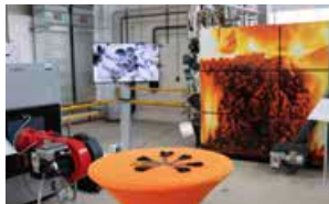
Die Energiezentrale im Benker-Areal ist eröffnet.
